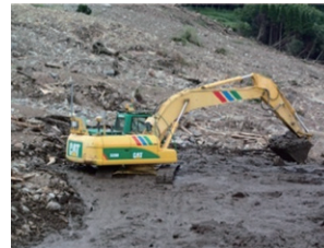
写真-7 降雨による足場の泥濁化
